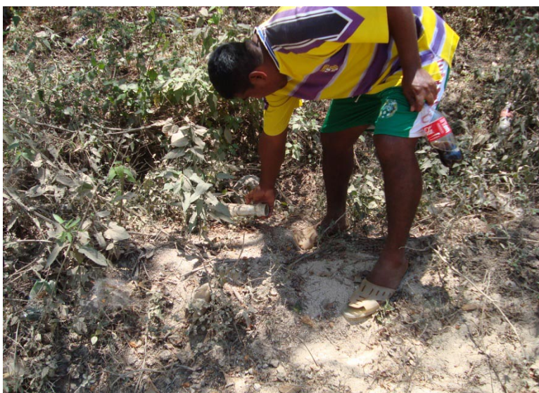
Foto. Red de agua inconclusa. El Tamarindo, Mpio. San Marcos. Fuente propia (2009)
