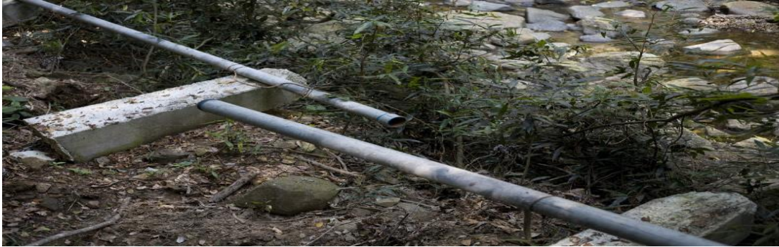
Figura 1. Destrucción de la infraestructura de agua en el ejido de Tecoaapa (Cabecera municipal).
